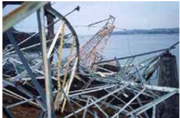
Høyspentmastene ved Karmsundet ble kraftig deformert. Store mengder stålprofiler lå forvridd og minnet mest av alt om en skraphaug.
