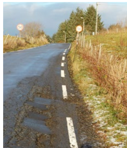
Asfalten sin tilstand i Spannaveien.
